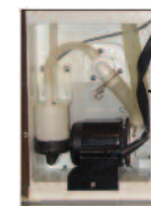
Compartimento seco de la bomba
